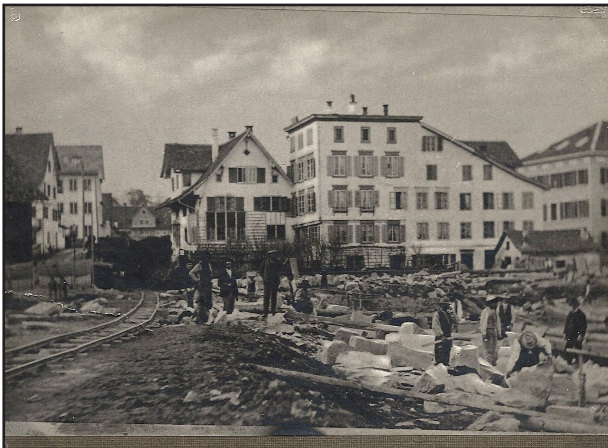
Hafenbau vor dem Bau der Eisenbahn In der Mitte das Haus von Prof. Wild
